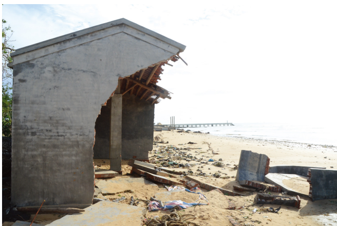
图7 广东省角尾乡房屋被风暴潮和近岸浪损毁 拍摄时间: 2014.9.17 16:30 坐标: 20°13'N, 109°55'E
